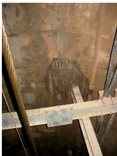
Bild 2. Oberstes leckendes Trägerauflager
