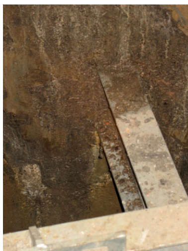
Bild 3. Nahaufnahme des obersten leckenden Trägerauflagers
